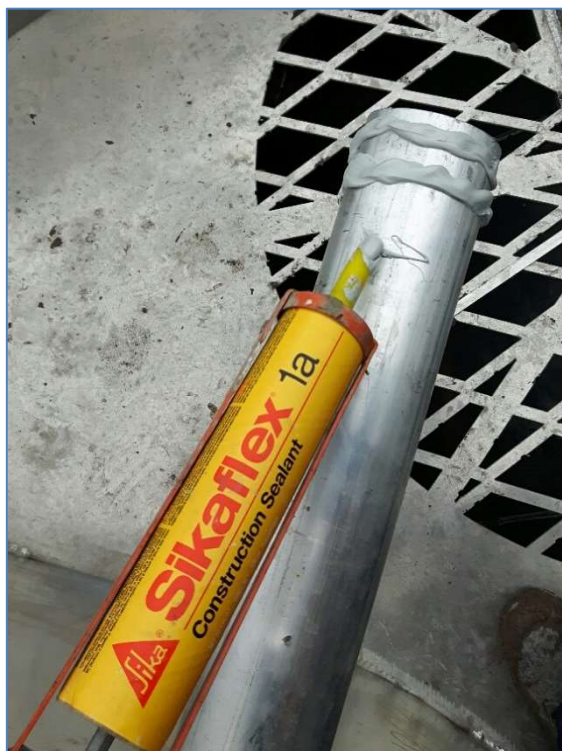
FIGURE 5: JOINT DÉTANCHÉITÉ SUR LE TUYAU D'HUILE
